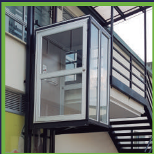
Ascensor Cabina Completa
