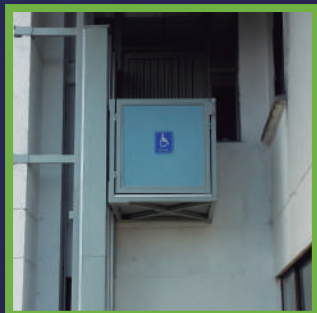
Ascensor Media Cabina
